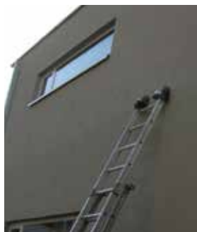
Fig. 32: échelle avec élément de répartition de charge.
