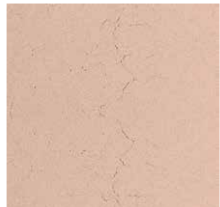
Fig. 25: Fissures de retrait
