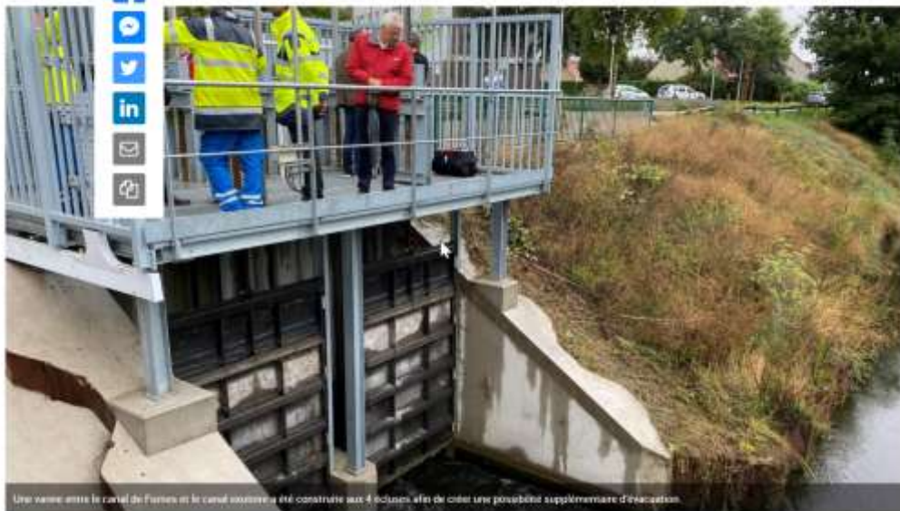
Une vanne entre le canal de Furnes et le canal ossewa a été construite aux 4 écluses afin de créer une possibilité supplémentaire d'évacuation.
